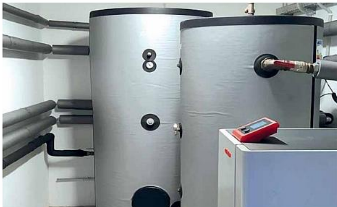
/ Pompy ciepła w Aleksandrowie Łódzkim mają istotnie zmniejszyć roczne zużycie energii pierwotnej i emisję gazów cieplarnianych
