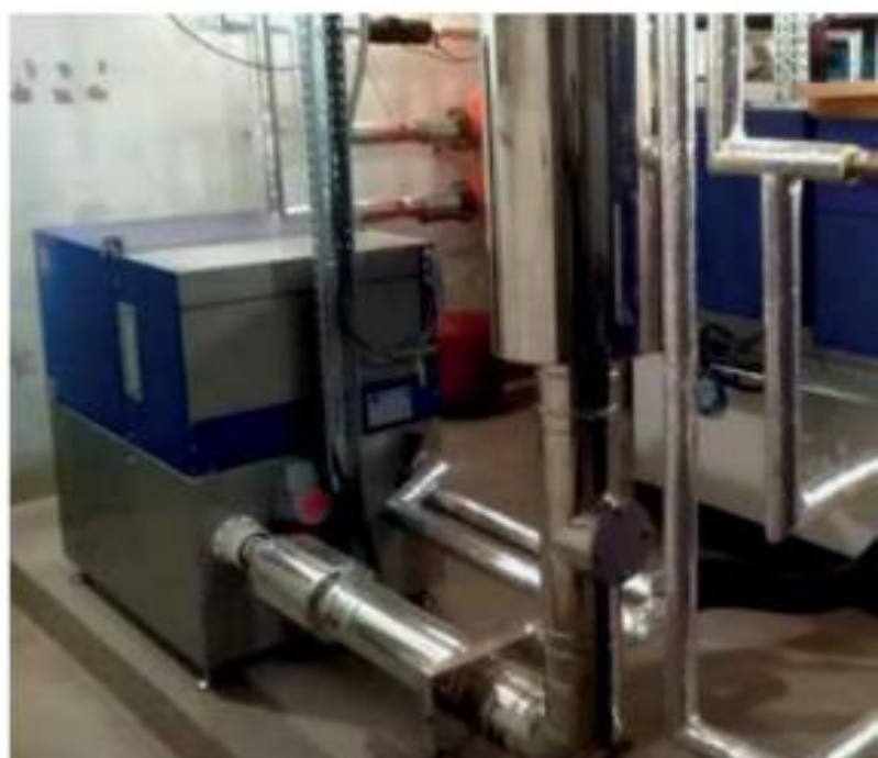
/ Pracujący w PCM mikrokogenerator gazowy MCHP-XRGI15
